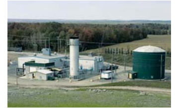
Installations de pompage et de traitement des biogaz.
