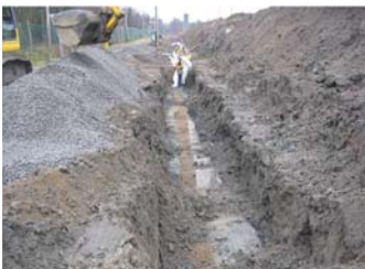
WM a aménagé une tranchée périphérique qui ceinture l'ancien secteur. Cet ouvrage permet d'intercepter de façon efficace les eaux de lixiviation et les biogaz.
