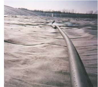
Réseau de collecte du lixiviat à la base de la cellule.
