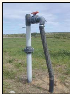
LA NOUVELLE CELLULE COMPTERA 238 PUITS DE CAPTAGE DES BIOGAZ RELIÉS EN RÉSEAU À LA STATION DE VALORISATION.
