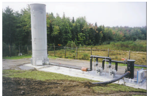
FIGURE 3.5 – TORCHÈRE D'INCINÉRATION DU BIOGAZ
