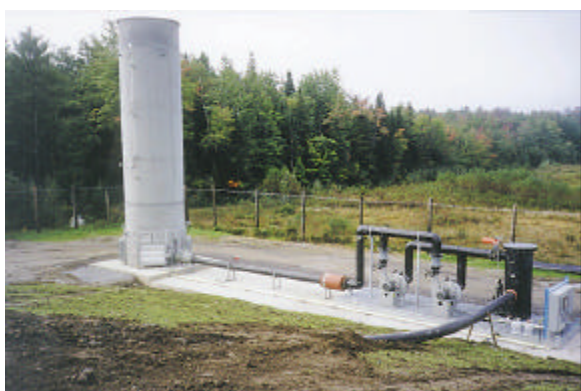
Figure 3.6 – Torchère d'incinération du biogaz
