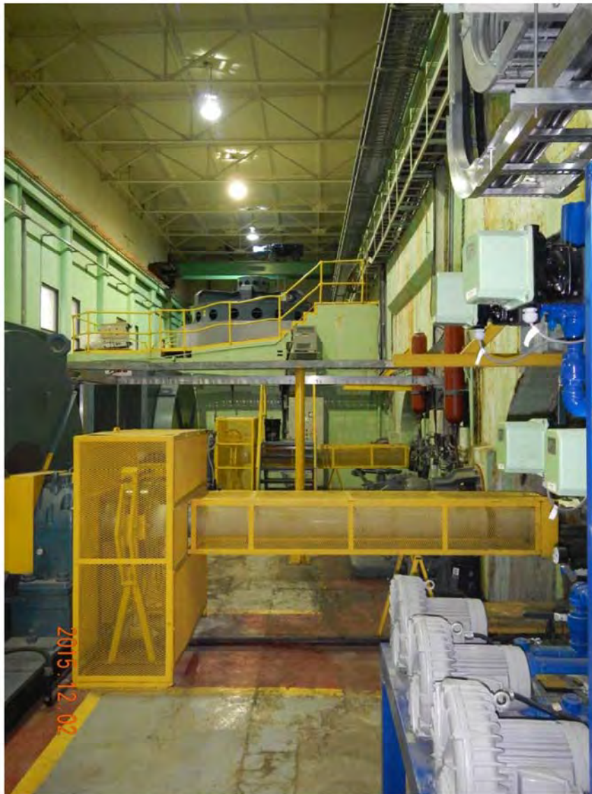
Photo 12 : Intérieur de la centrale
