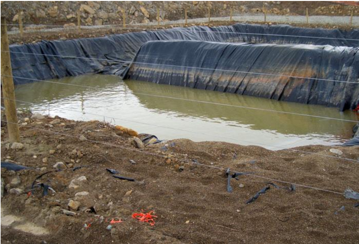
Photo 17 : Bassin de réception des eaux de fracturation. Source www.donnan.com
