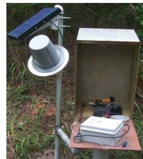
Figure 1 — Puits de surveillance muni d'un équipement de télémétrie par satellite
