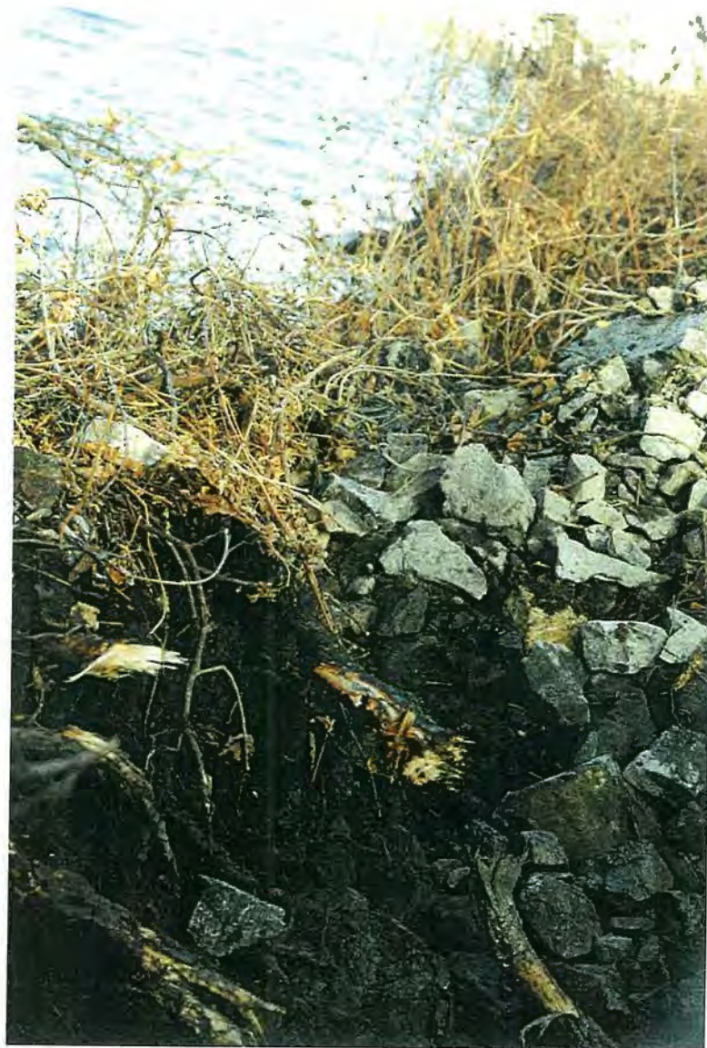
Photo 12: Positionnement des racines de l'Orme, dans le sol, par rapport au niveau d'eau du réservoir.
