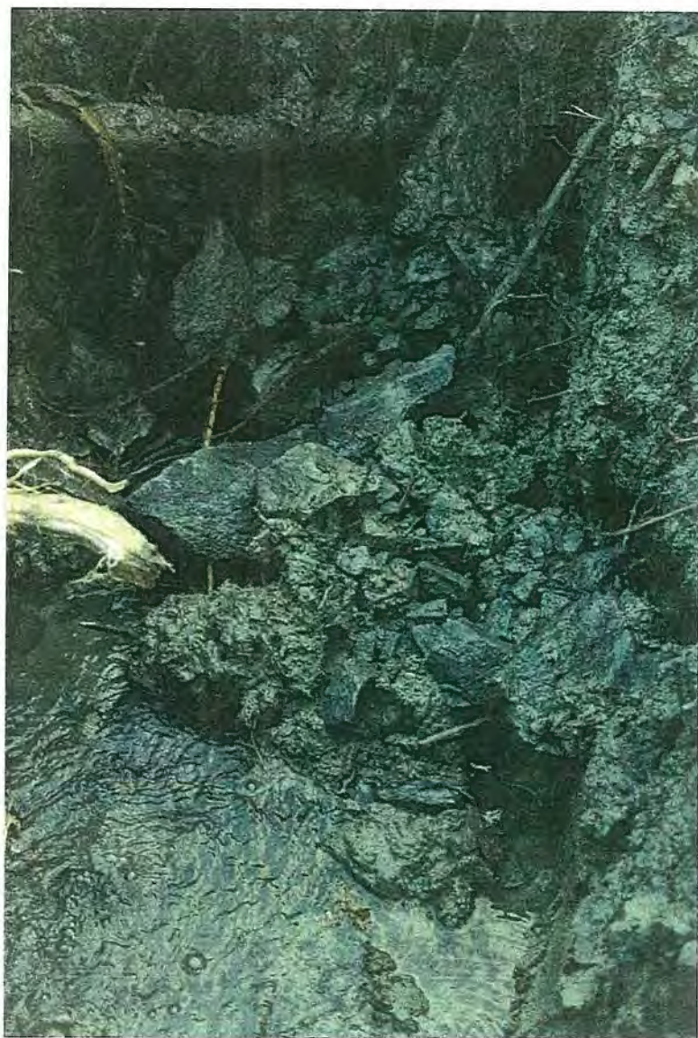
Photo 14: Infiltration d'eau. On remarque, en arrière-plan, la racine principale d'Orme qui a pénétré dans le noyau d'argile.
