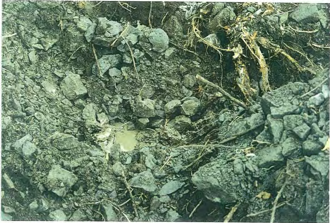
Photo 13: Infiltration d'eau décelée lors du creusage et probablement créée suite à un bris dans le noyau d'argile.
