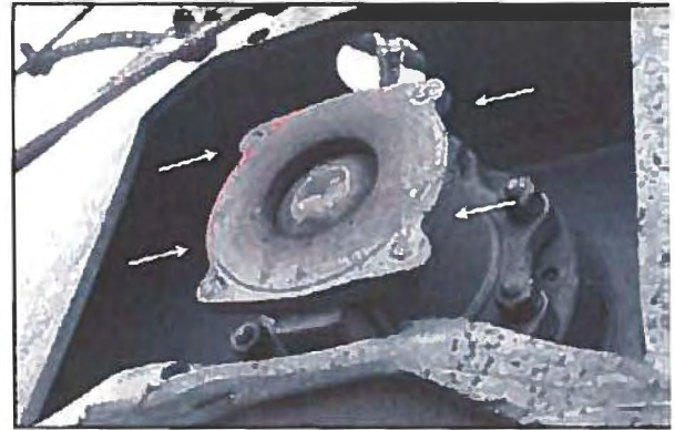
Photo 26. Robinet de déchargement par le bas dont le manchon a été cisailé
