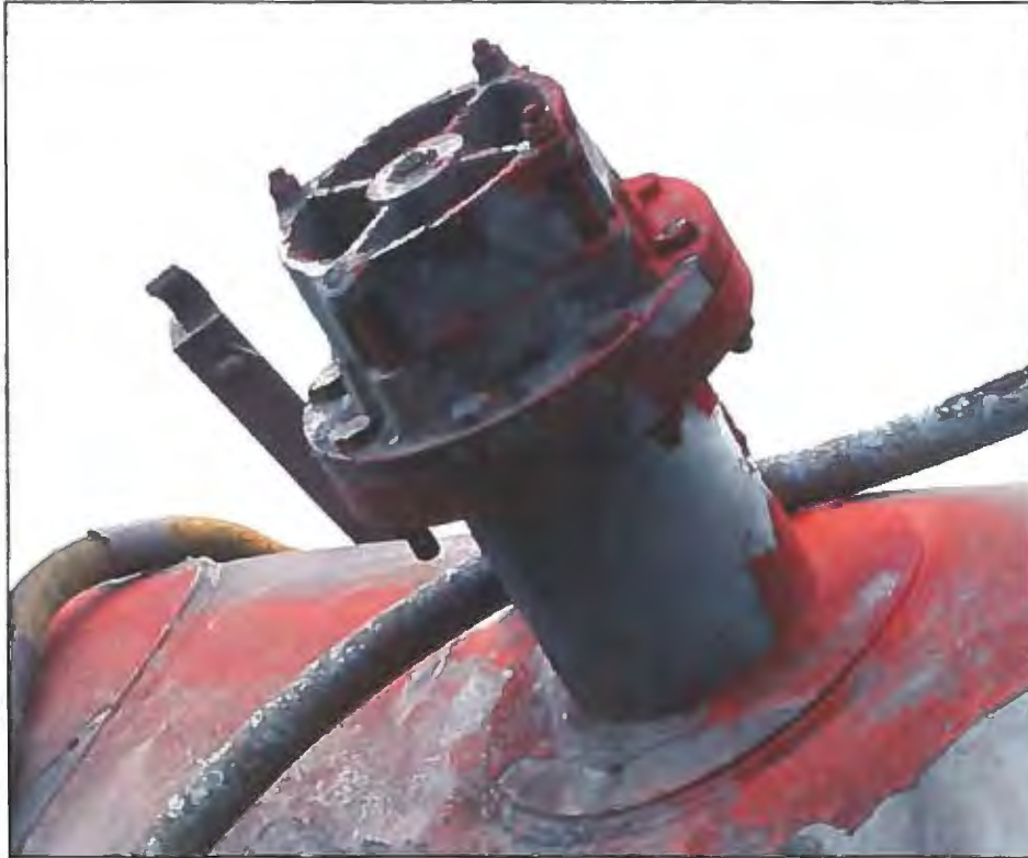
Photo 24. Dispositif de décharge de pression
