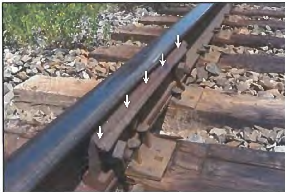
Photo 15. Éclisse endommagée à cause du contact avec les boudins de roue
