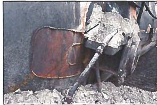
Photo 18. Longrine centrale tronquée endommagée
