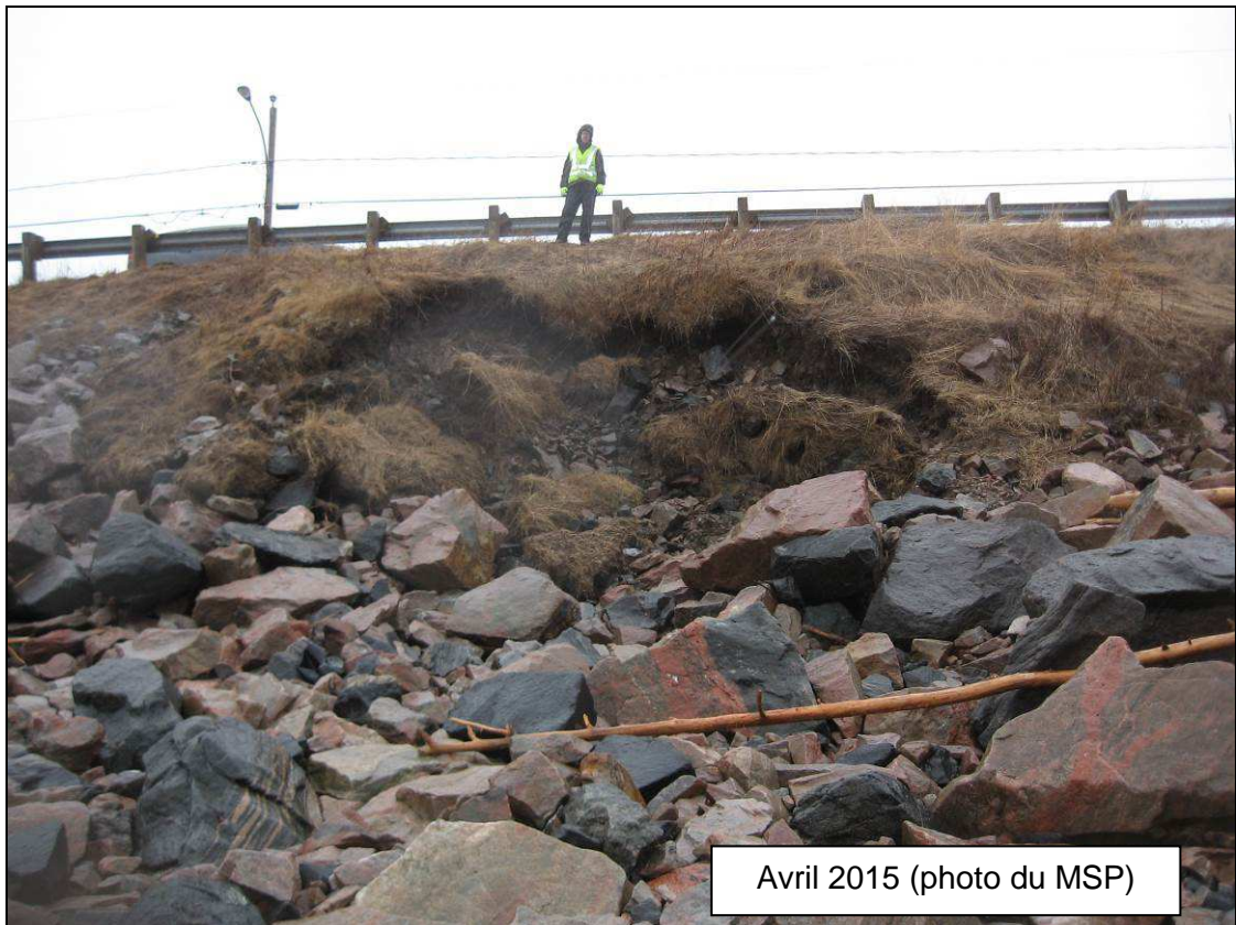
Figure 5 : Vues de la falaise, plus ou moins vis-à-vis le 87, rue Labrie (Glissement C).
