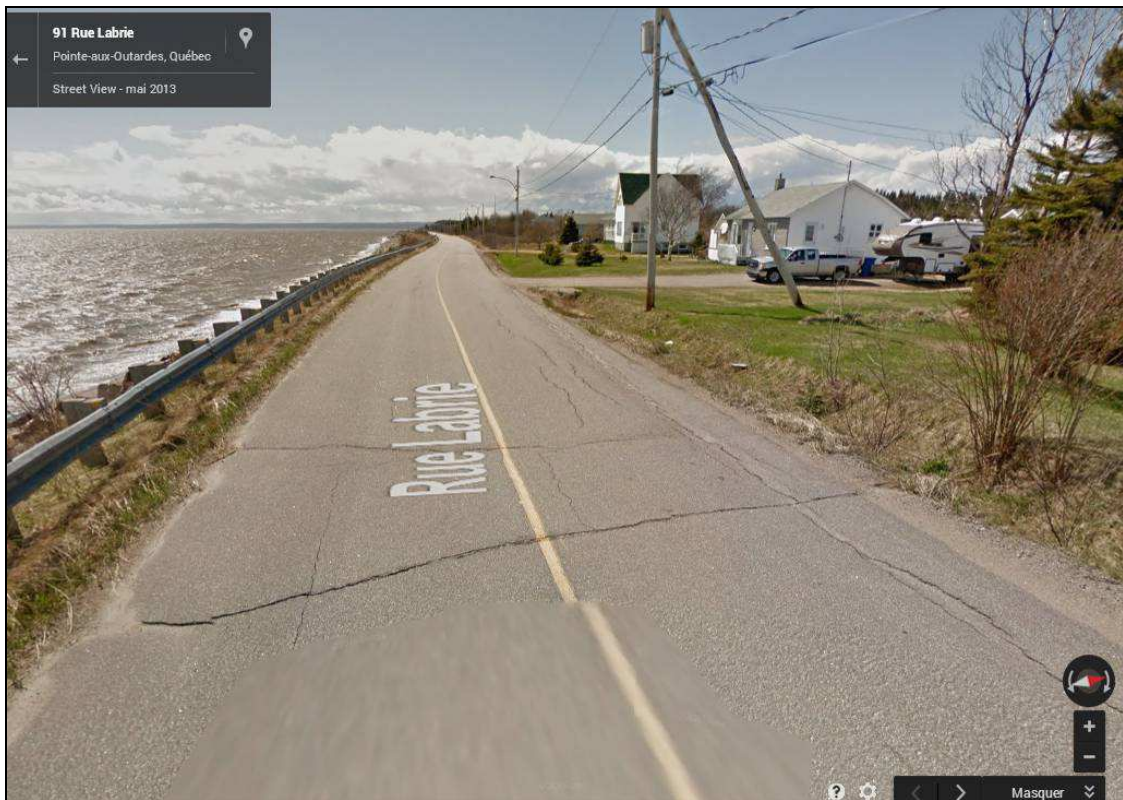
Figure 4 : État de la chaussée en face du 91, rue Labrie. Fissures observées du côté opposé au talus. Date de l'image : mai 2013. Source : Google Street View, © Google.
