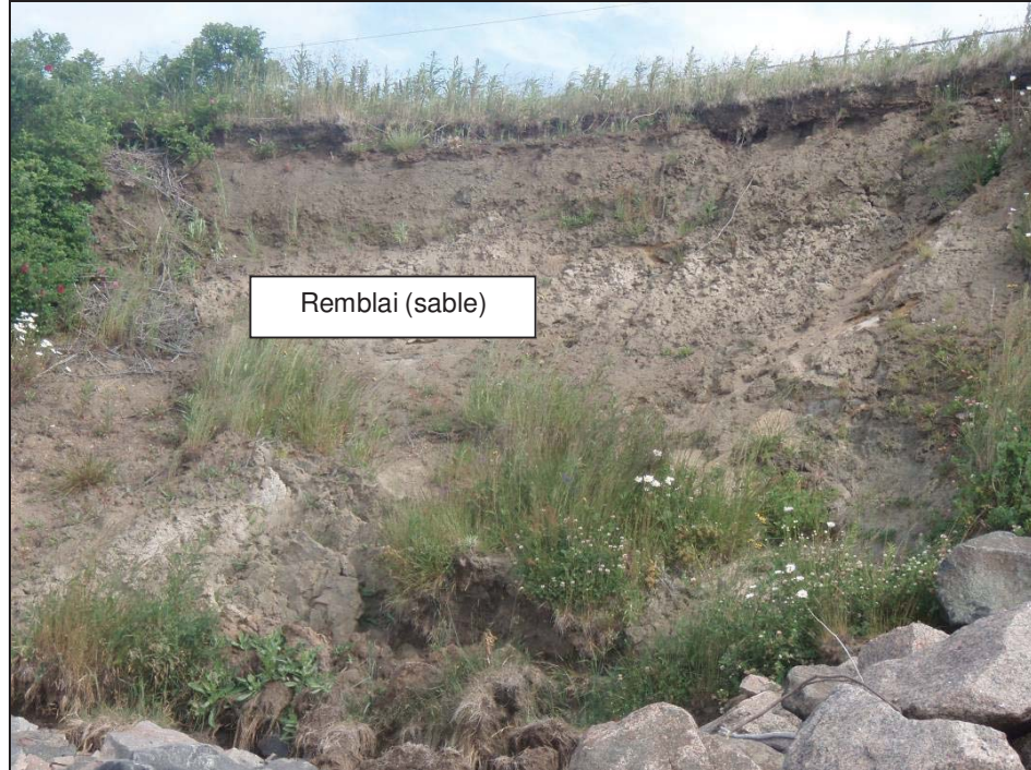
Figure 6 : Vue de la falaise affectée par un glissement de terrain en face du 97 de la rue Labrie, en juillet 2013.
