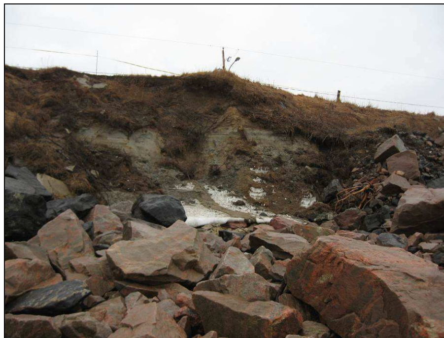
Figure 2 : Vue du glissement de terrain situé plus ou moins en face du 101, rue Labrie (Glissement A : photo du MSP).
