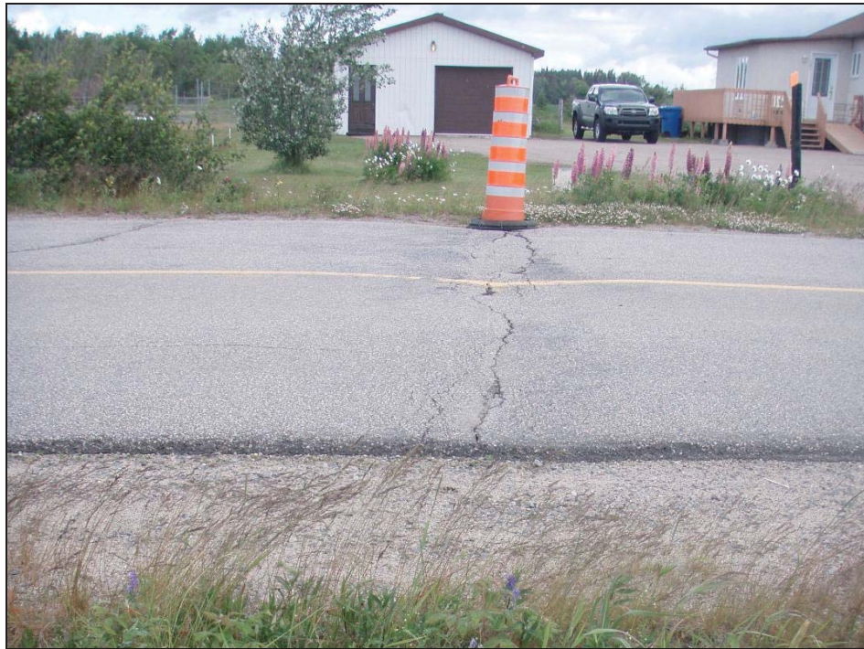
Figure 14 : Zone de déformation (affaissement) observée sur la chaussée dans l'alignement du ponceau (11 juillet 2013).
