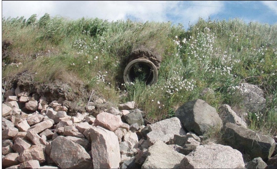
Figure 13 : Section de ponceau ayant basculé dans la pente entre les adresses civiques du 97 et du 101, rue Labrie (11 juillet 2013).
