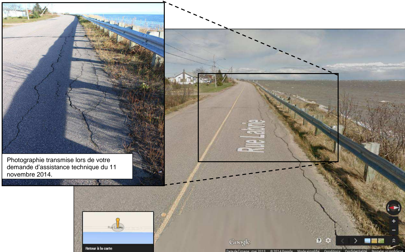
Figure 2 : État de la chaussée dans le secteur du 83, rue Labrie. Date de l'image de fond : mai 2013. Source : Google Street View, © Google.
