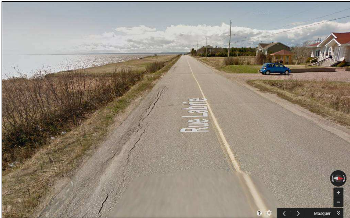
Figure 3 : État typique de la chaussée entre les adresses civiques 45 à 75, rue Labrie. Date de l'image : mai 2013. Source : Google Street View, © Google.
