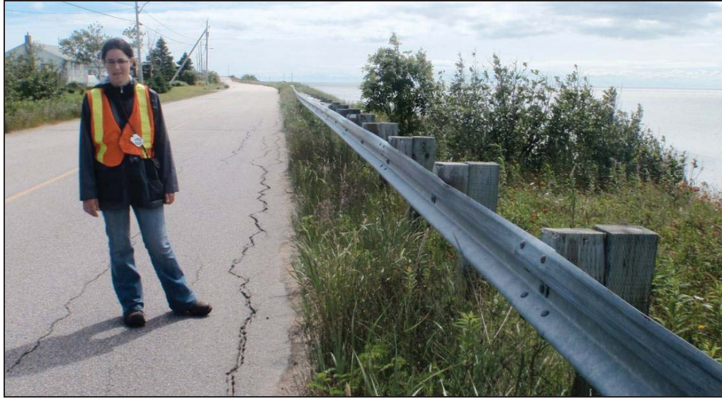
Figure 21 : Exemple de fissures observées en bordure de la chaussée en face du 83 de la rue Labrie (11 juillet 2013).
