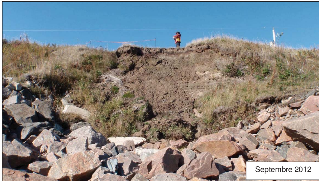
Figure 9 : Vues de la même falaise affectée par un glissement de terrain en face du 101 de la rue Labrie, en 2011 et 2012.
