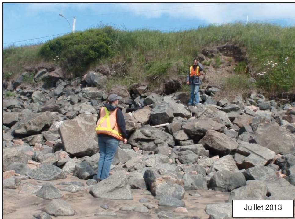
Figure 15 : Vues du même point d'érosion observé en face du 83 de la rue Labrie, en 2011 et 2013.
