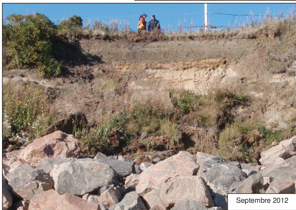
Figure 5 : Vues de la même falaise affectée par un glissement de terrain en face du 97 de la rue Labrie, en 2011 et 2012.
