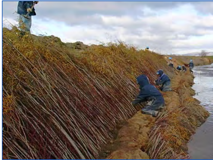
Figure 4-19. Mise en place d'une fascine, jumelée à une couche de plançons et des branches anti-sapement
