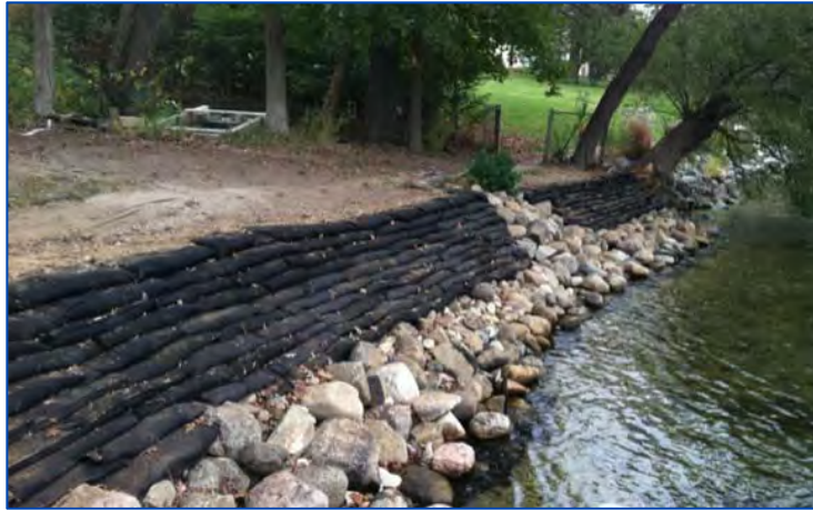
Figure 4-11. Enrochement du pied de berge jumelé à des sacs Envirolok® sur la partie moins sollicitée (source : Envirolok, lac Geneva)
