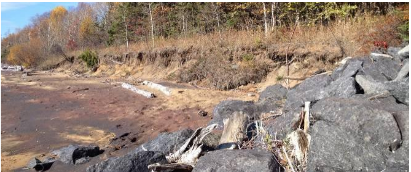
Figure 20 - Érosion à l'extrémité ouest du perré situé le long du km 1 de la piste cyclable du parc.
