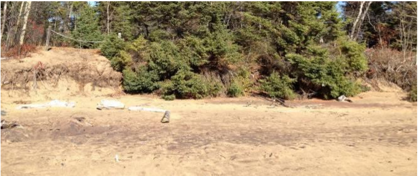
Figure 17 - Érosion à l'extrémité est du perré situé au km 1 de la piste cyclable du parc.
