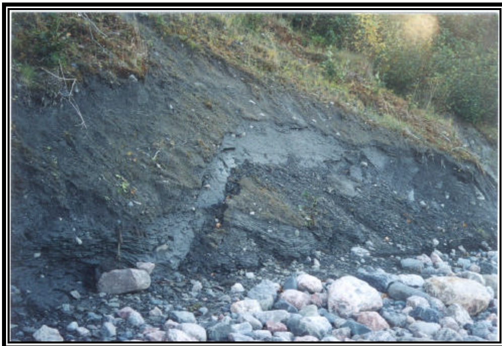
PHOTO 6 : Erosion du till de fond à la base du talus.
