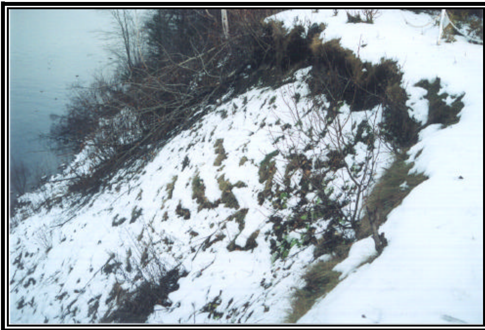
PHOTO 2 : Vue d'un effondrement d'un secteur en surplomb.
