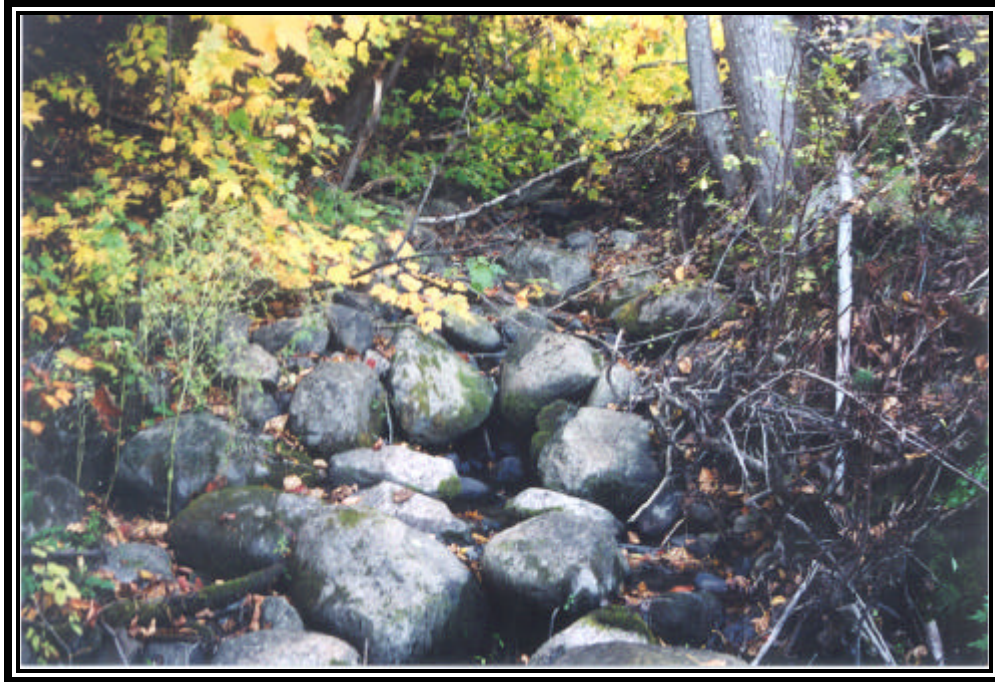
PHOTO 7 : Accumulation de cailloux et blocs au niveau du lit d'un ruisseau.
