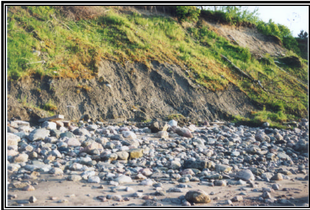
PHOTO 4 : Érosion en base du talus.
