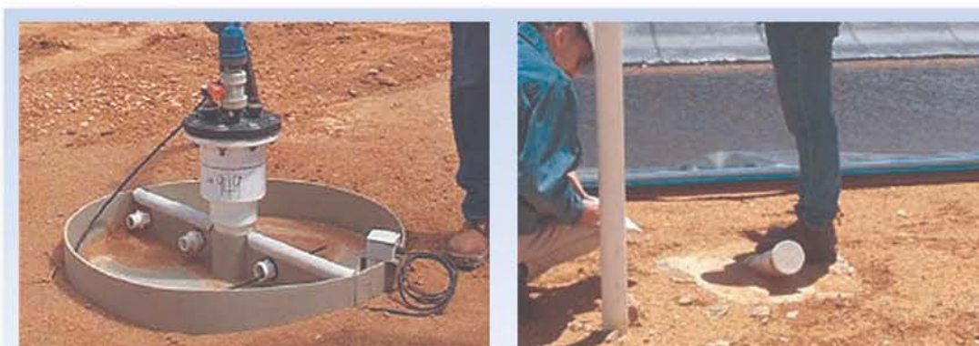
Tête de puits avec bac de récupération et détecteur en ligne (à gauche) ; bassin d'évaporation avec détection de fuites (à droite) à la mine LIS de Beverley. Un processus EIA complet basé sur une compréhension approfondie des conditions locales du site, des essais sur le terrain et des données environnementales initiales, démontrant que le confinement du puits sur le terrain était nécessaire avant d'obtenir l'approbation pour commencer les opérations. Un suivi environnemental continu garantit que l'installation fonctionne comme prévu.
