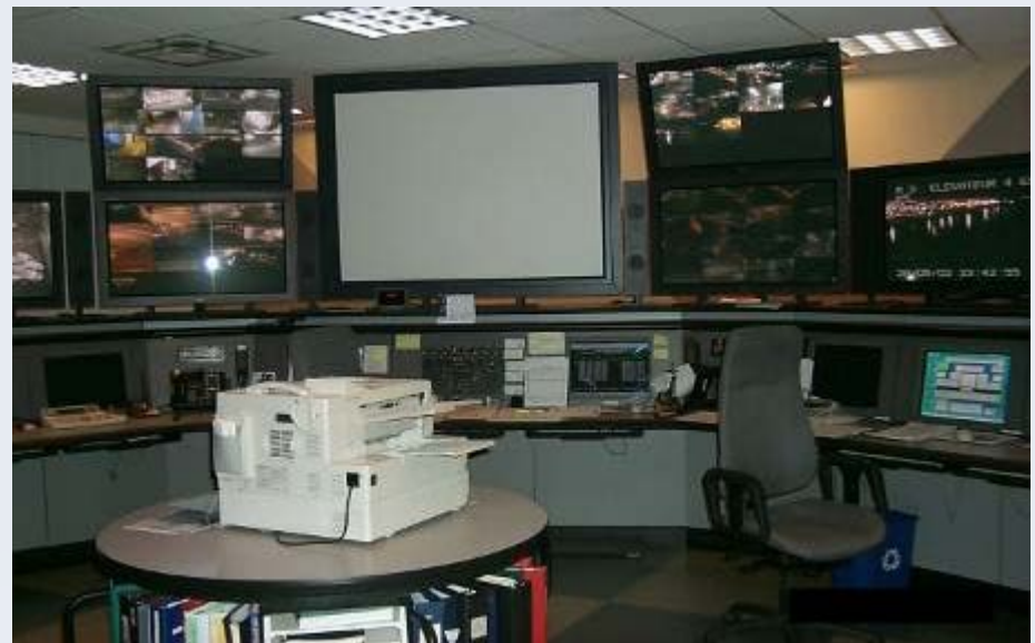
Centre de contrôle de l'APM
