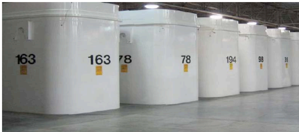
Figure 4.4 — Conteneurs de stockage à sec à l'installation de gestion des déchets Pickering
