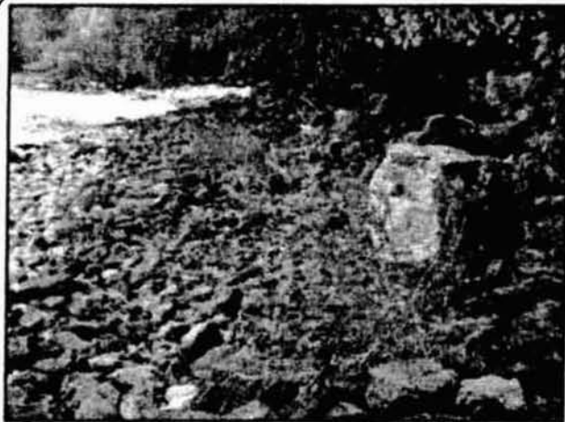
Photo N° 3 : Débris de scories et de roches en surface d'une berge.
