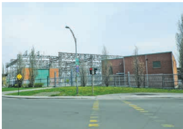
Photo 4 : Vue du poste électrique Atwater
