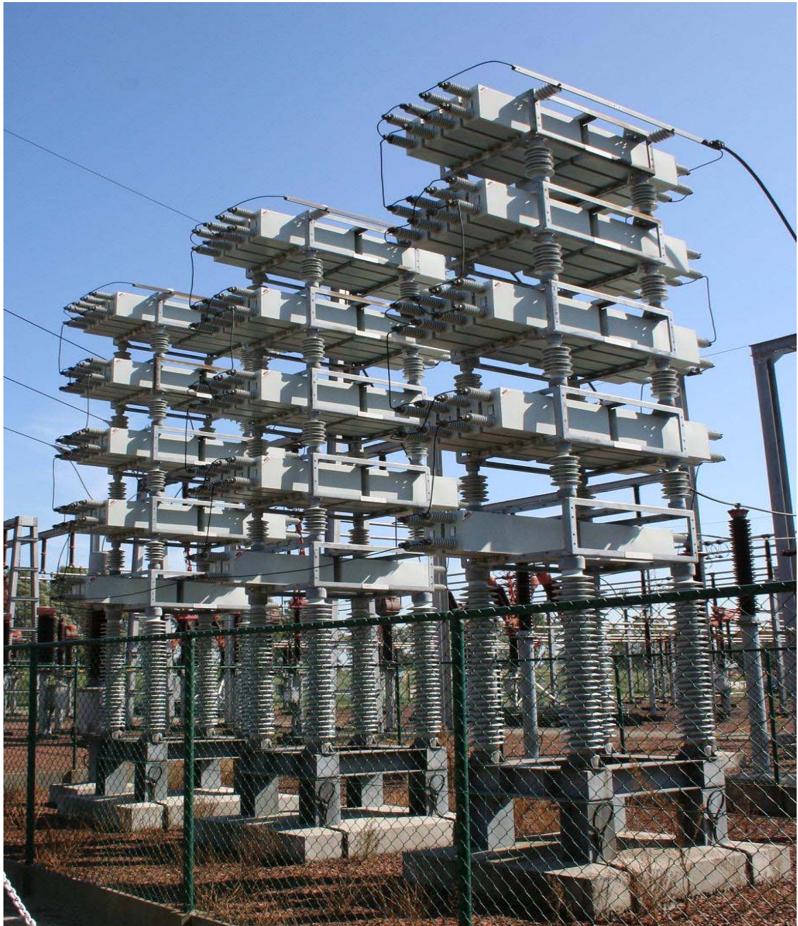
FIGURE 2.2 Batterie de condensateurs typiquement utilisée dans les stations électriques (source : http://commons.wikimedia.org/wiki/File:Condensor_bank_150kV_-_75MVAR.jpg )
