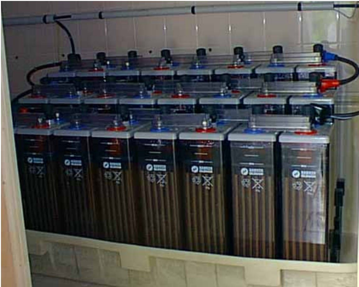
FIGURE 2.3 Banc d'accumulateurs typiquement utilisé dans les stations électriques
