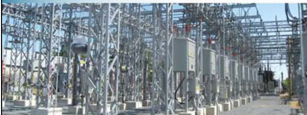
Exemple d'une section à 25 kV au poste de Saint-Maxime, dans l'arrondissement Saint-Hubert
