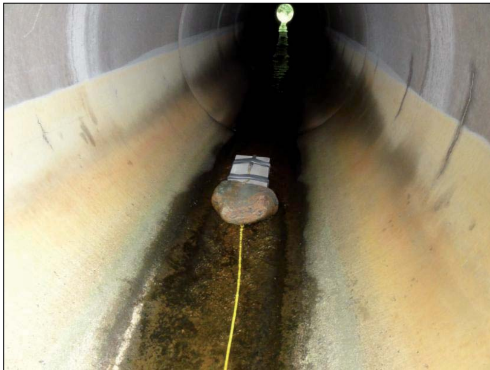
Photo 23 Montage typique d'une sonde dans un ponceau (ponceau 76) (23 juin 2012).
