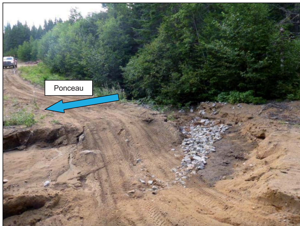
Photo 11 Ruisseau Clet (site 46) – Érosion du chemin du Vieux-Sept-Îles à la suite du débordement du ruisseau (28 août 2012).
