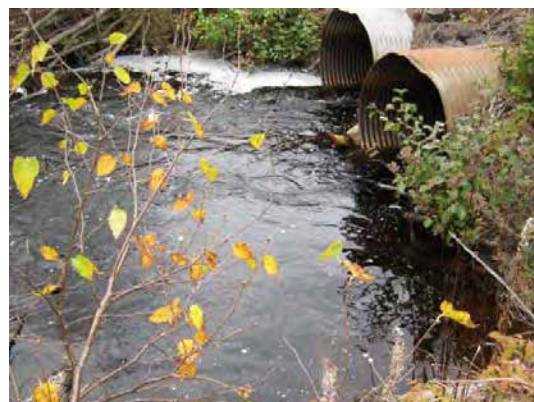
Photo 6 Fosse située dans le ruisseau sans nom, à la sortie du ponceau de la voie ferrée (octobre 2010)
