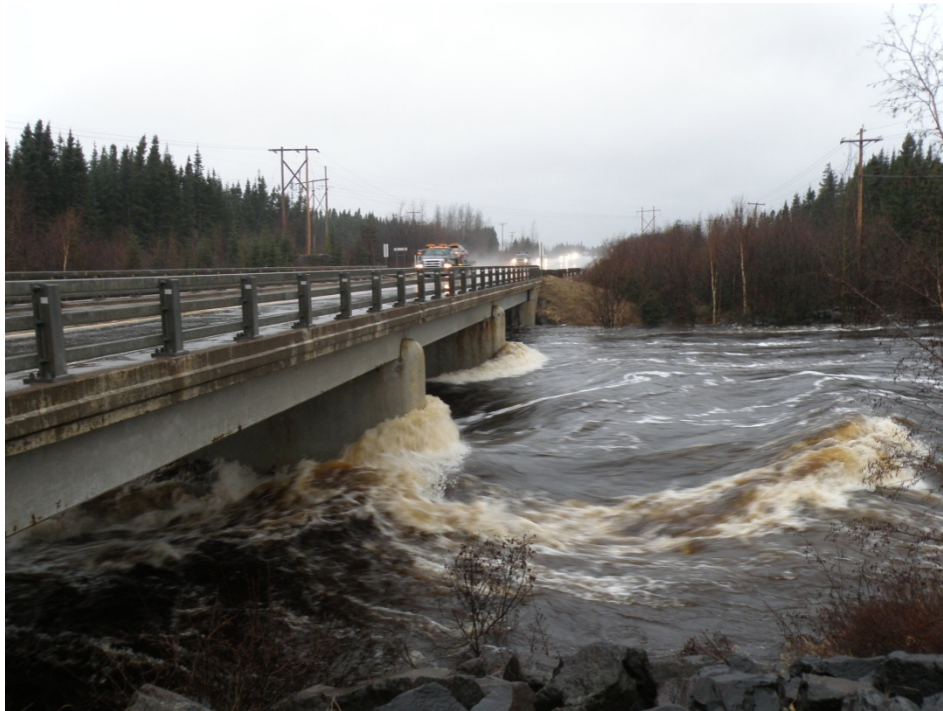
Photo du pont de la rivière Rapides, à la route 138, en décembre 2010
