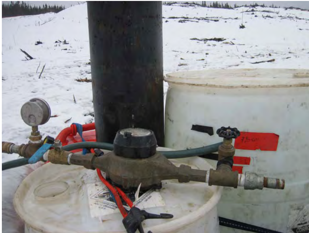
Photo 7 Régulateur de pression et compteur d'eau, en date du 12 mars 2012.
