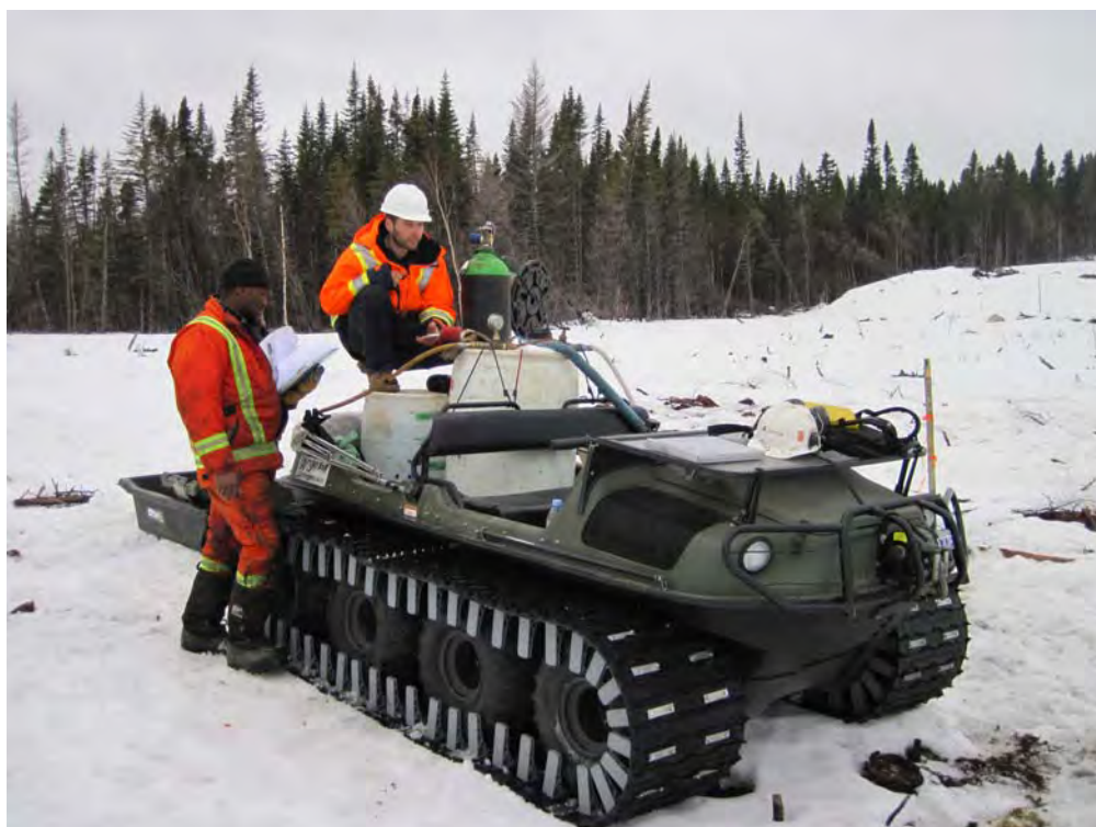
Photo 10 Suivi des variations de volumes injectés dans le puits pour différents paliers de pression, en date du 12 mars 2012.
