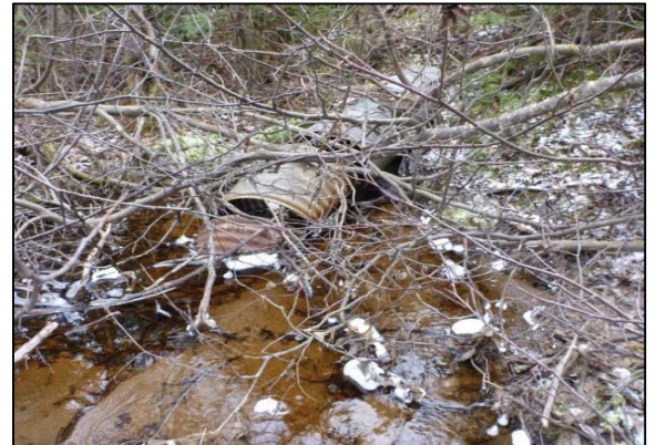
Photo 3 : Ouverture aval du ponceau endommagé
