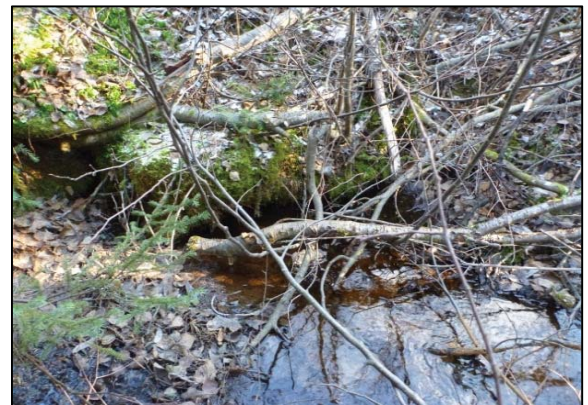
Photo 3 : Assise du chemin dépourvue de ponceau, écoulement par percolation
