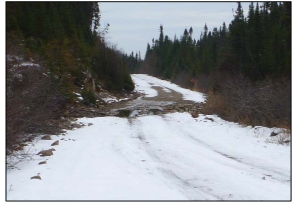
Photo 3 : Refoulement du bassin (seg 6) par-dessus la route 20 m au sud
