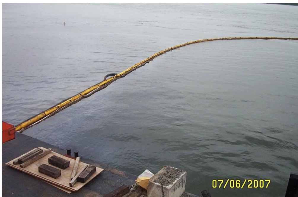
Photo 3 : Vue en surface du rideau de confinement retenant les sédiments
