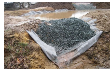
Photo F.14 : Trappe à sédiments avec berme filtrante
