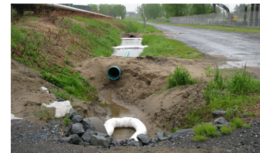
Photo I.4 : Boudins absorbants installés au niveau d'un ponceau inversé
