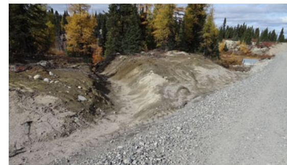
Photo F.10 : Fossé de déviation des eaux de ruissellement, projet de raccordement du complexe de la Romaine
