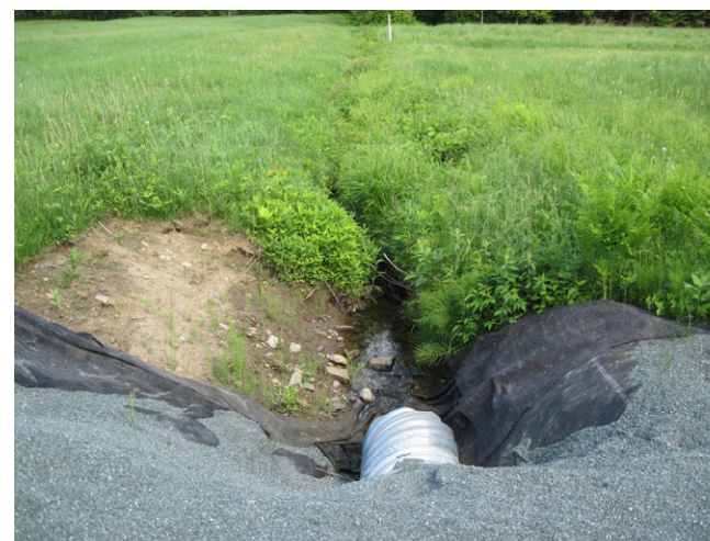
Photo D.2 : Ponceau installé dans un fossé agricole, projet de la ligne Nicolet-Bécancour
