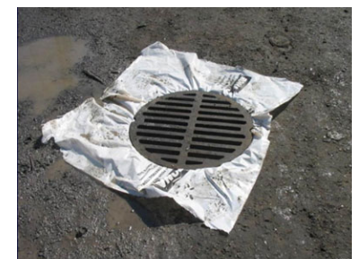
Photo F.17 : Membrane installée sous le couvercle d'un puisard (source : MTQ, 2014)
