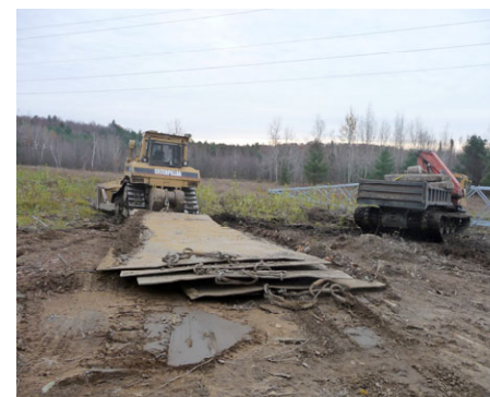
Photo A.7 : Plaques d'acier utilisées pour le déplacement de la machinerie dans une tourbière, projet de la ligne Chénier-Outaouais
