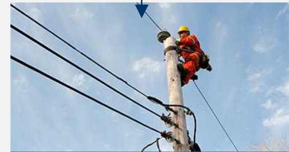
RÉSEAU DE DISTRIBUTION
