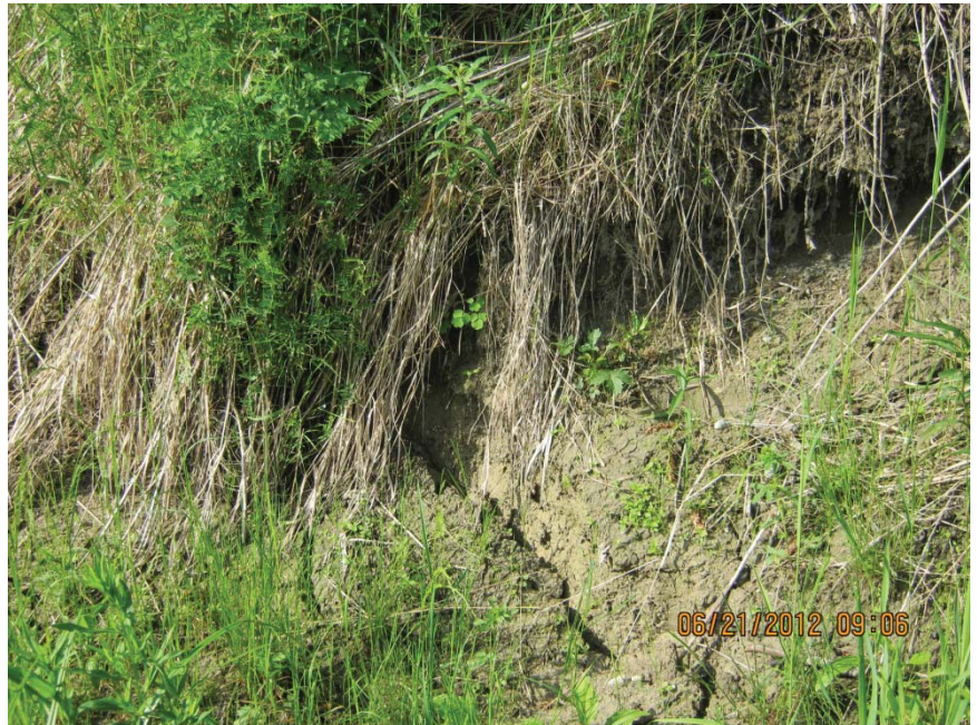
Photo 22 Zone de décrochage du talus
