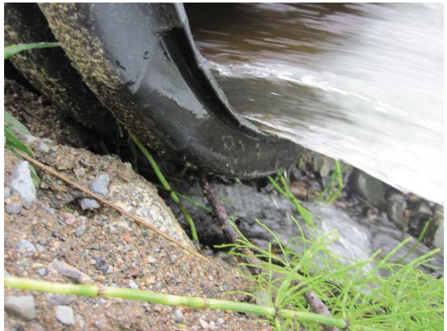
Photo 8 Fuite d'eau sous le ponceau en PEHD 450 mm de diamètre
