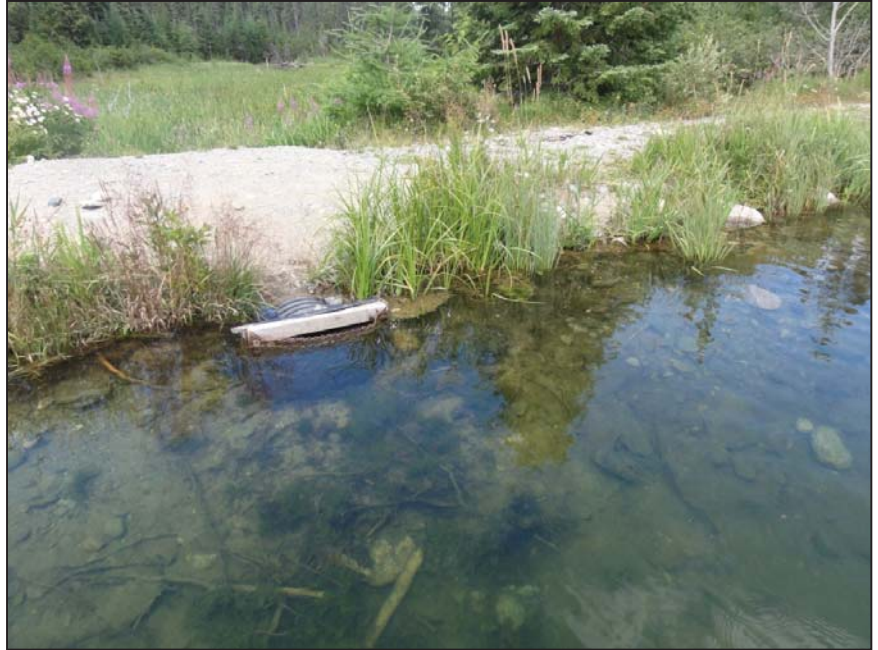
Photo 1 Conduite PEHD 450 mm de diamètre avec grillage.
