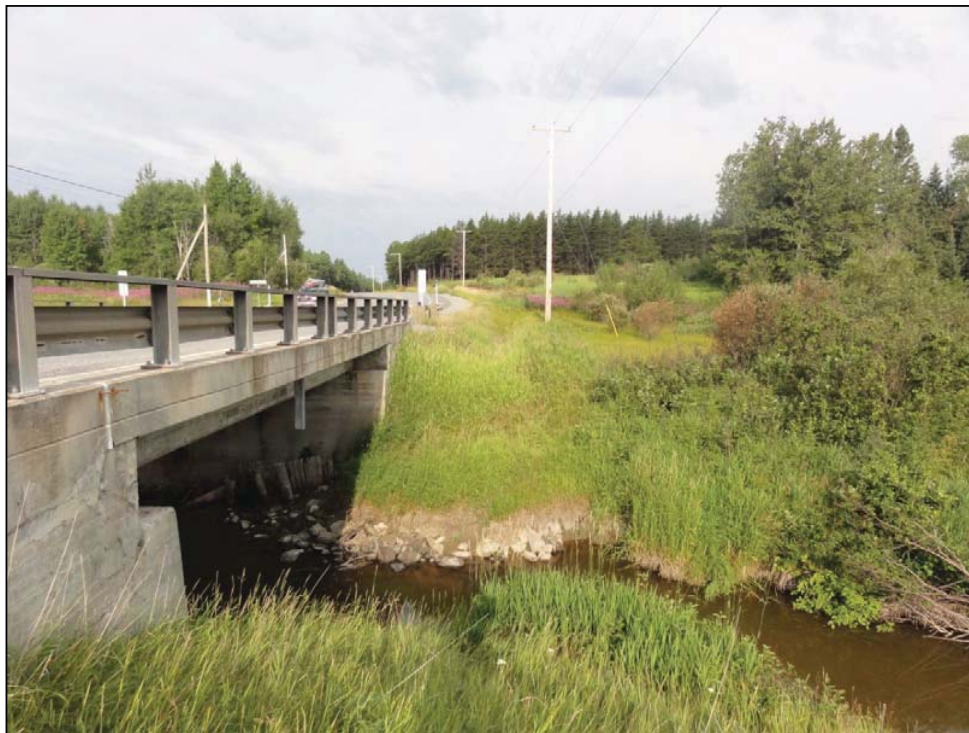
Photo 8.4b 2 août 2012 – Pont de la route 111 – Confluence du ruisseau (PK 44+227) – amont ( Q=0,5 \text{ m}^3/\text{s} ).
