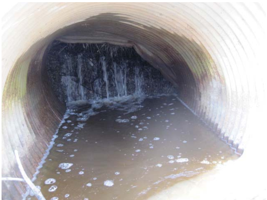
Photo 13 Obstruction du ponceau au niveau du barrage de castor
