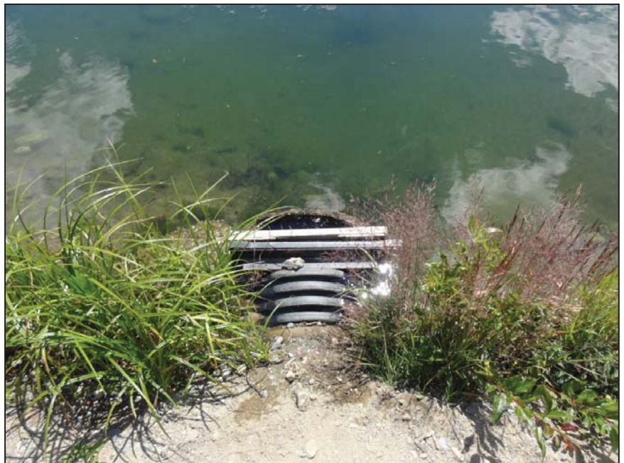
Photo 2 Conduite PEHD 450 mm de diamètre avec grillage.
