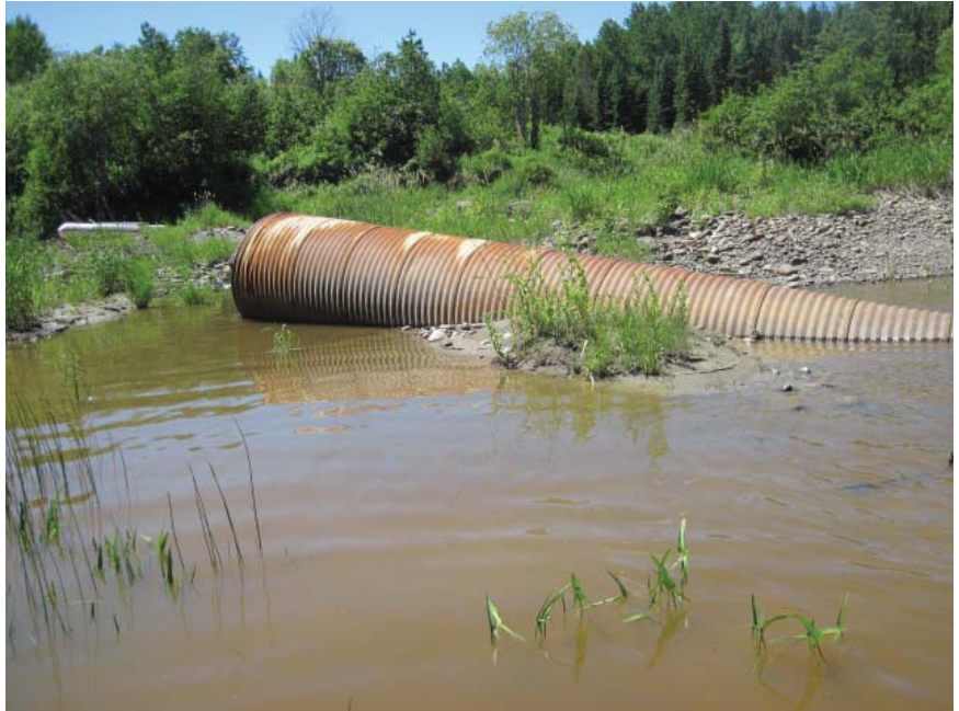
Photo 20 Ancien ponceau échoué en aval dans la rivière Octave
