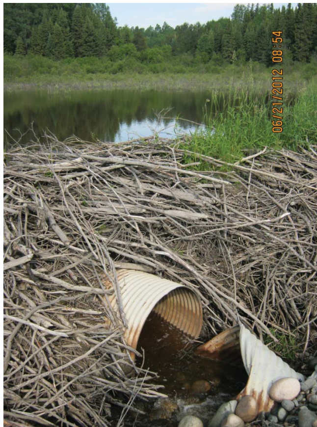
Photo 9 État du ponceau entre le barrage et la route
