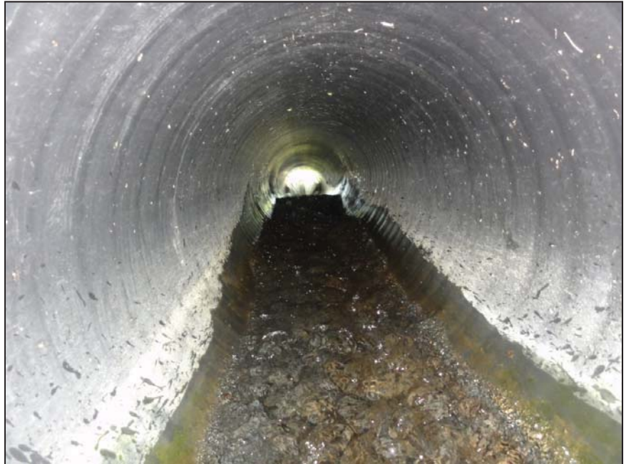
Photo 7 Déformation du ponceau
