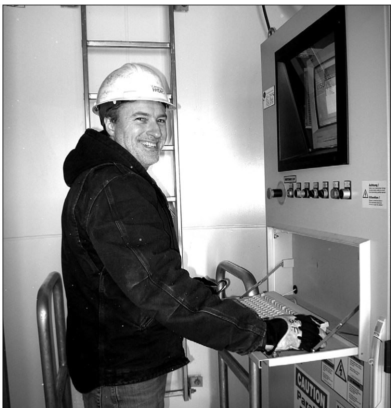
Du cœur d'une éolienne, Scott Forsyth a accès aux mêmes données électroniques qu'à partir de son bureau.
