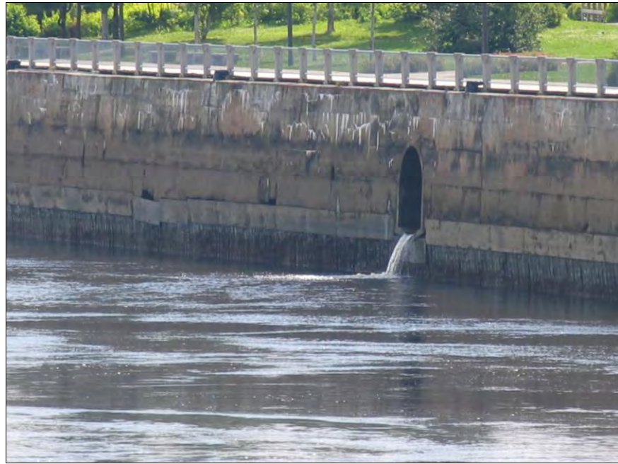
Figure 24. Débordement de conduite unitaire, secteur du Vieux-Port de Chicoutimi.
