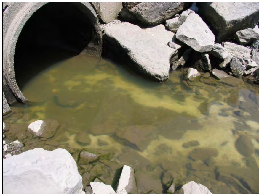
Figure 25. Débordement de conduite unitaire, Chicoutimi-Nord.
