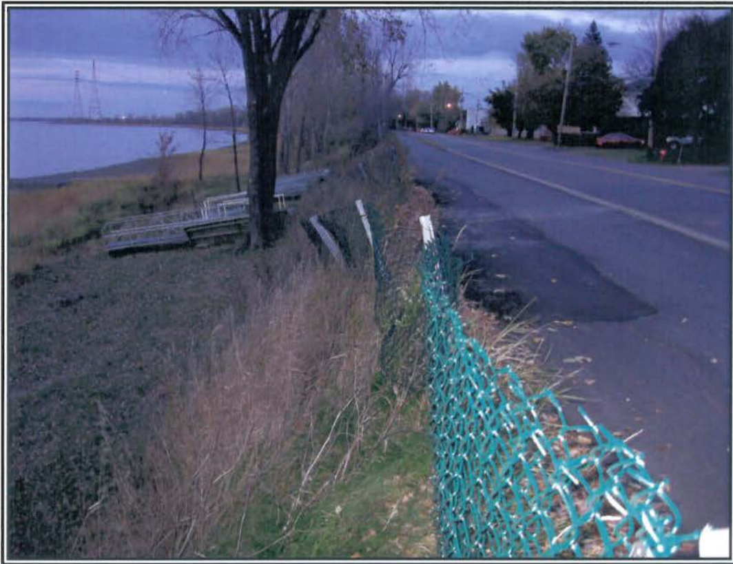
Photographie no 1: Secteur du forage F-01, vue vers le nord-est. Inclinaison de la clôture vers le fleuve.
