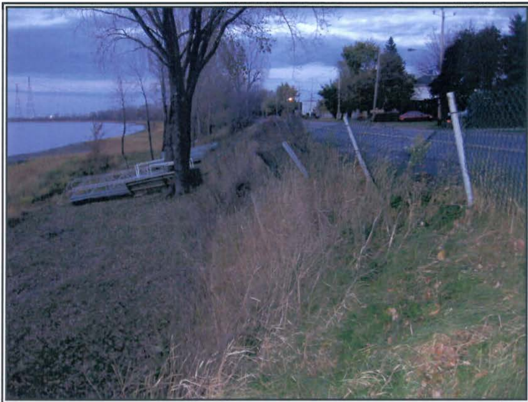
Photographie no 2: Secteur du forage F-01, vue vers le nord-est. Inclinaison de la clôture vers le fleuve.
