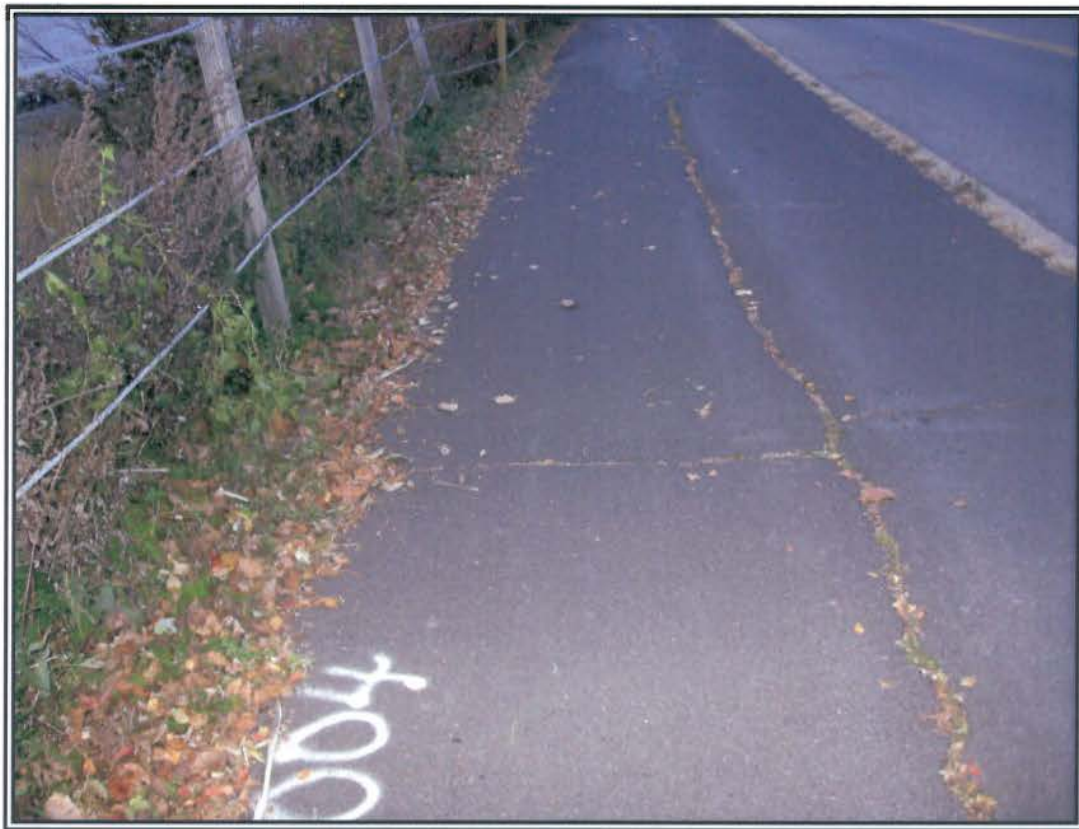
Photographie no 9: Secteur du forage F-04. Fissuration.
