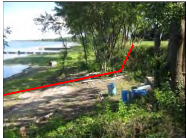
Figure 9. Aperçu de signes d'affaissement de la piste cyclable (Source : Aqua-Berge, 2009).
