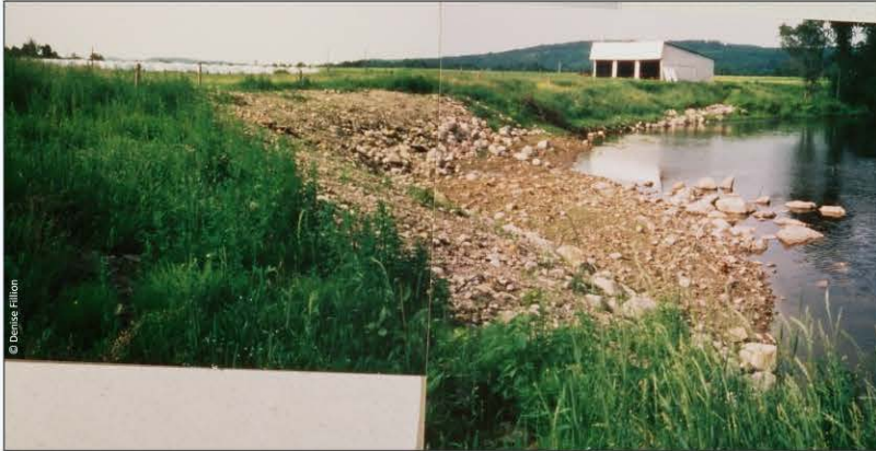
Affaissement de l'enrochement l'année suivante Erreurs??
