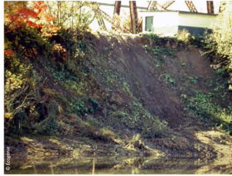
Avant les travaux de stabilisation en 1996: talus argileux érodé (h:10 mètres): longueur 30 mètres
