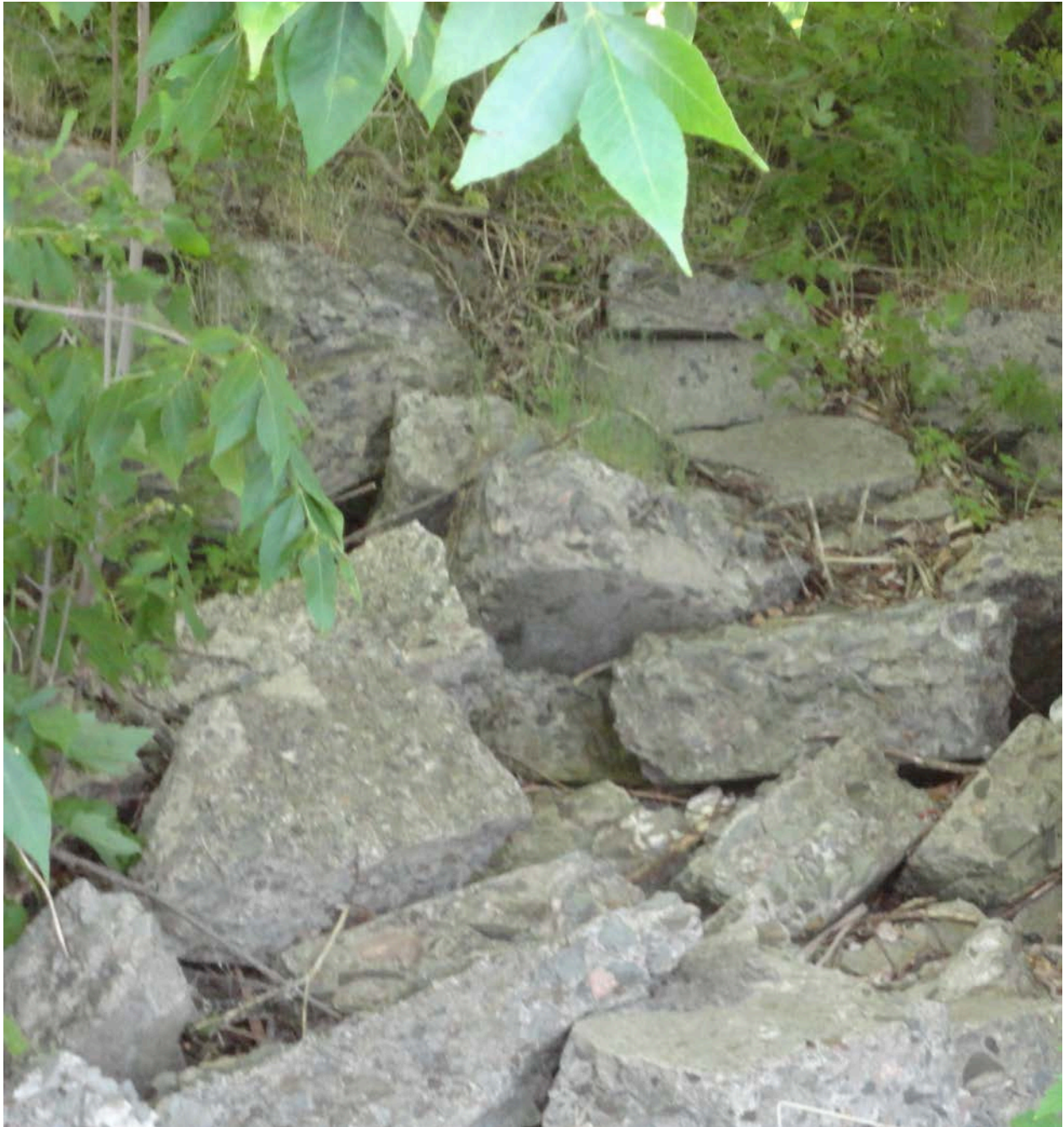
Photo-3 – Déplacement des blocs de béton
