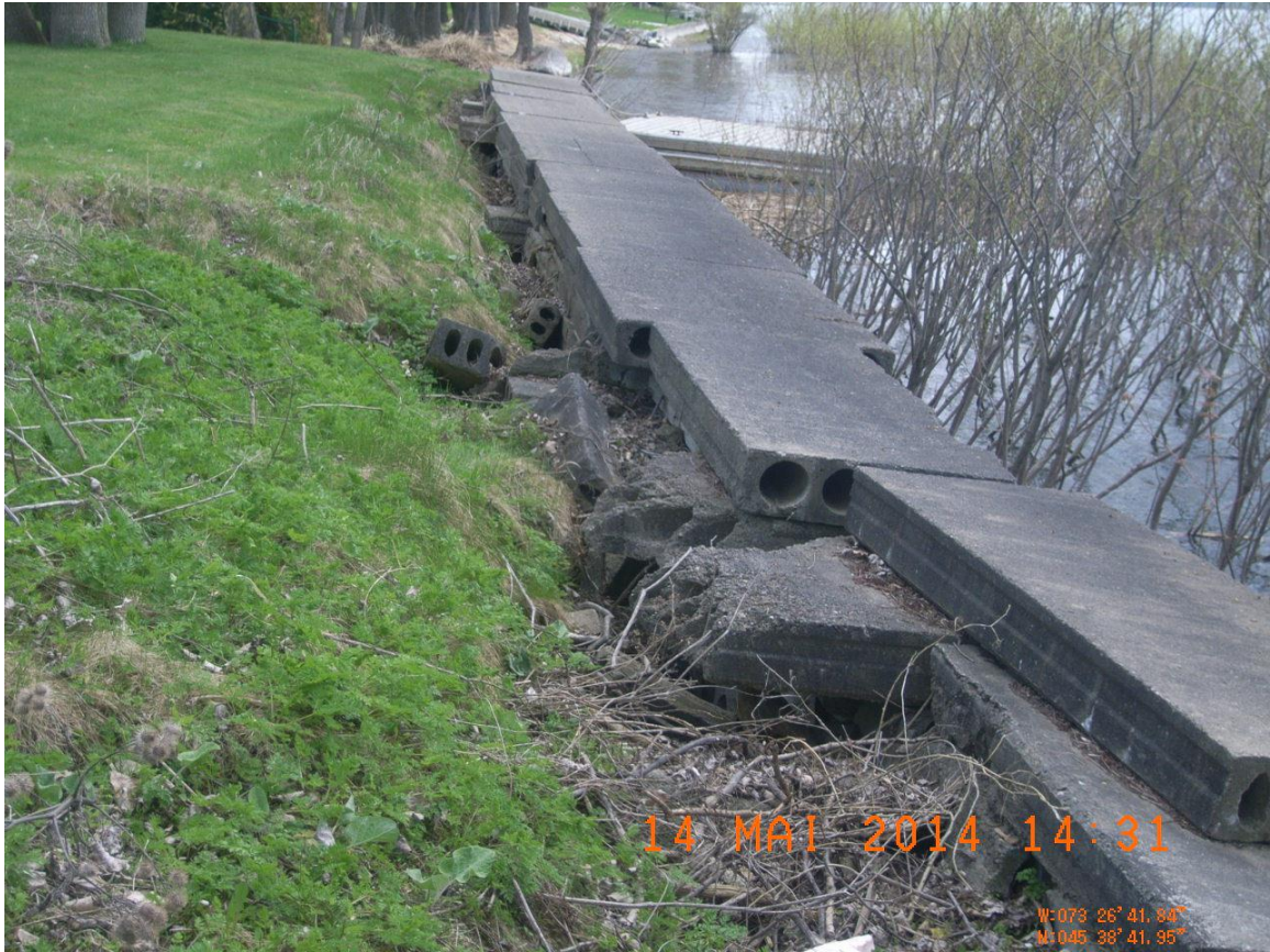
Photo 10 Muret au parc de la Saulaie - vue vers le sud.
