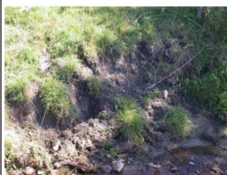
Pt 31: Érosion du talus
