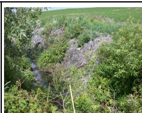
Pt 141: Érosion de talus
