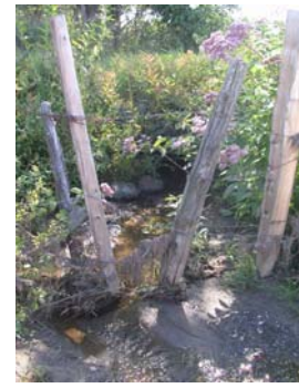
Pt 31: Clôture, sédiments et débris
