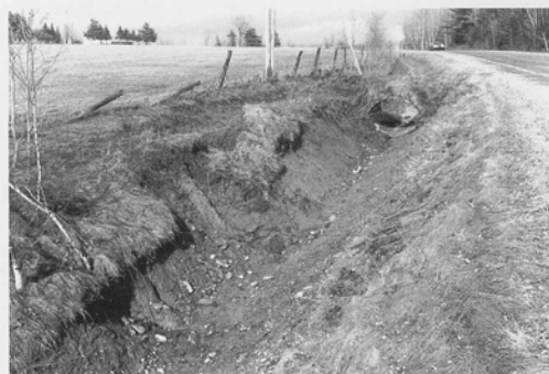
Photographie no 1 : Section nettoyée à l'été 1995 selon la méthode traditionnelle. Cette photographie prise au printemps 1996 permet de constater les effets dévastateurs de l'érosion (solifluxion et décrochage) sur les talus du fossé. (Route 222-01-140, vue vers l'est) (Photo: RAPPEL)
