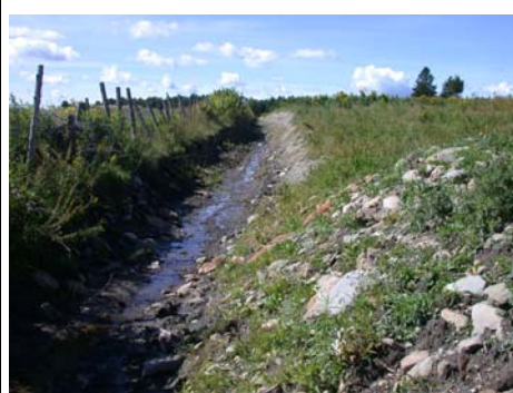
Pt 31: Mauvais entretien du fossé
