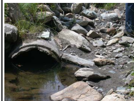
Pt 171: Ponceau bloqué et érosion
