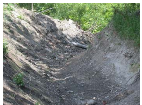
Pt 161: Fossé sans végétation
