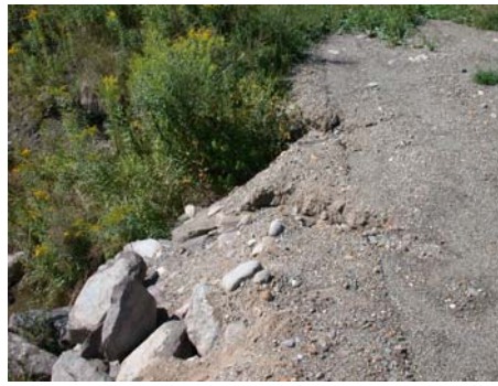
Pt 29: Érosion du ponceau
