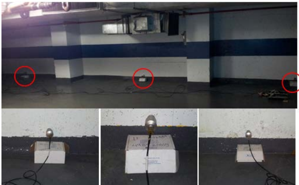
Figure 7-5 : Emplacement des capteurs dans le garage
