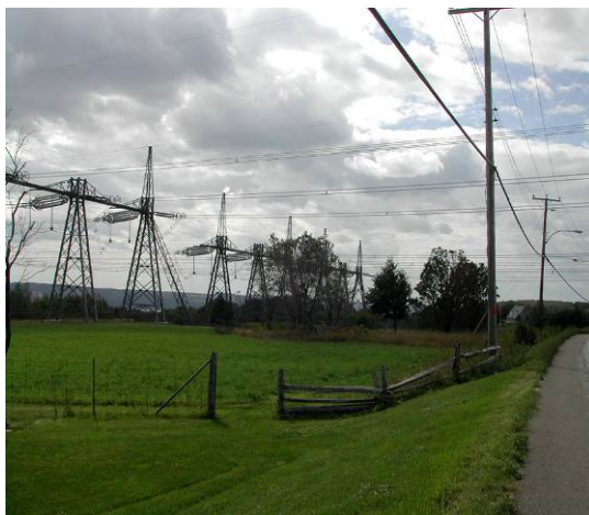
La ligne aérienne de transport d'énergie et ses pylônes, sur l'Île d'Orléans
