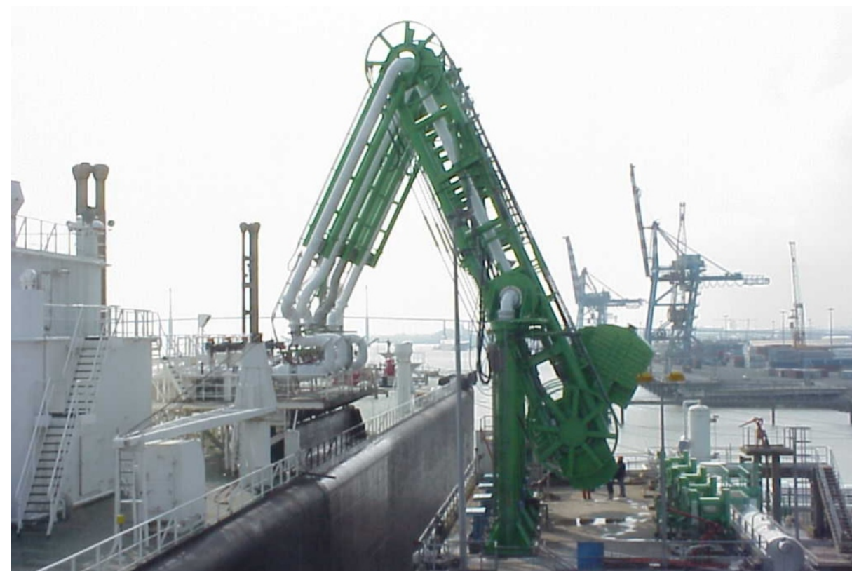
Bras de déchargement connectés à un méthanier sur un des appontements du terminal méthanier de Montoir-de-Bretagne / Unloading arms connected to a LNG tanker at jetty head of the Montoir-de-Bretagne LNG terminal
