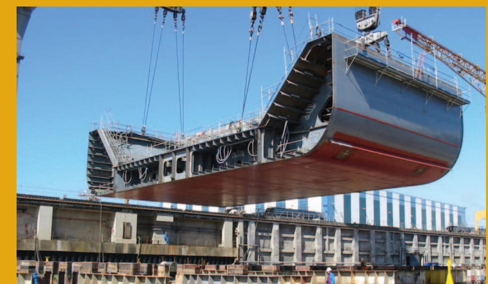
Double coque d'un méthanier.
