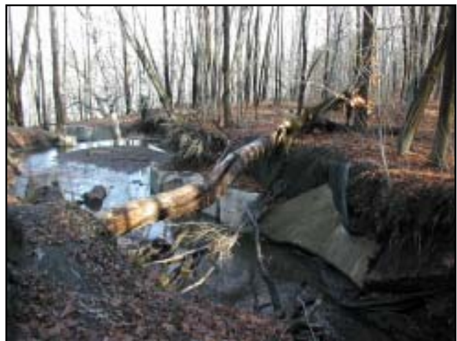
Photo 36 Le ruisseau Lecours est soumis à une forte érosion en raison d'un trop fort débit du réseau pluvial de la ville en provenance des secteurs urbains environnants (coll. : BPH)
