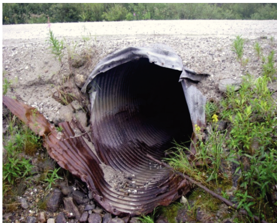
Photo 2.4 Recouvrement insuffisant et déformation de la section
