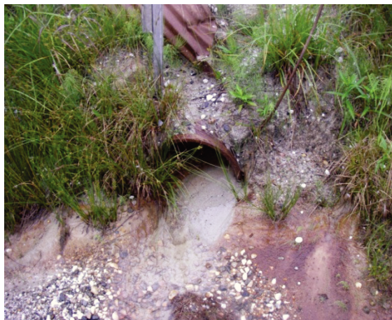
Photo 2.5 Réduction du rendement hydraulique occasionnée par la sédimentation
