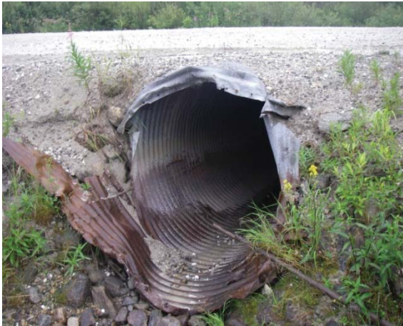
Photo 2.17 Recouvrement insuffisant et déformation de la section
