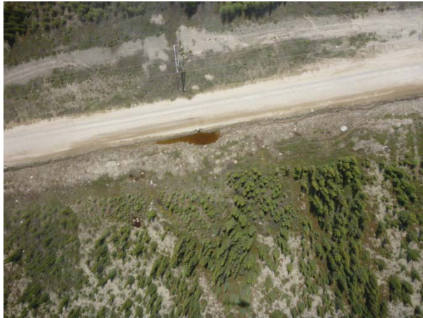
Photo 2.27 Accumulation d'eau dans le fossé, à proximité d'un ponceau aux environs du km 540
