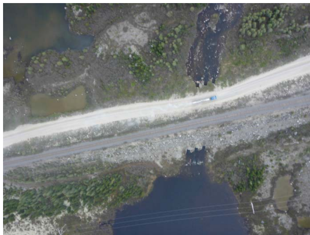
Photo 2.22 km 522 : affluent de la rivière aux Pékan – trois ponceaux en parallèle (Structures P-12410-12411-12412)
