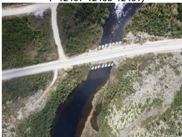
Photo 2.26 km 480,1 : Petite rivière Manicouagan - Sept ponceaux en acier 3 200 mm en parallèle (Structure P-10313)
