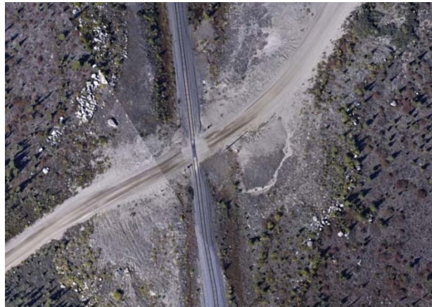
Photo 2.13 km 525,16 : passage à niveau 10 (signalisation avec panneaux d'arrêt) – Non conforme
