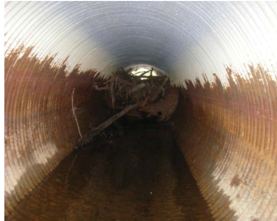
Photo 2.18 Corrosion de la paroi et barrage de castors
