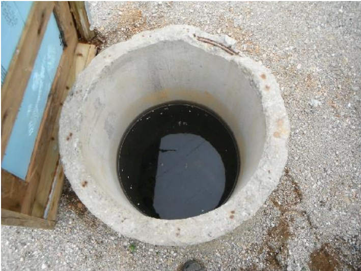
photo 23 puits de captage de l'eau souterraine
