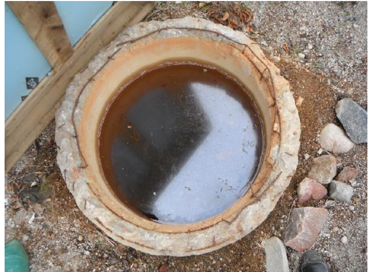
photo 24 puits de captage de l'eau souterraine
