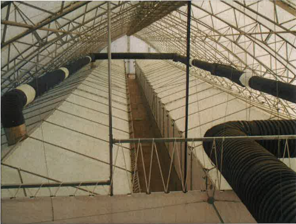
Un système de ventilation soutire l'air vicié
