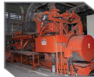
Une des génératrices de la centrale électrique de BFI à Lachenaie.
