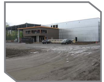
L'avancement de la construction du centre de tri de Terrebonne, à la mi-mai 2007.
