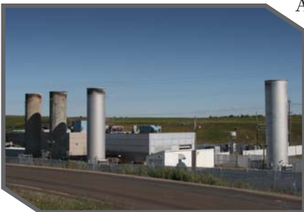
La centrale électrique de BFI fonctionne à la combustion des biogaz et produit quatre mégawatts.
