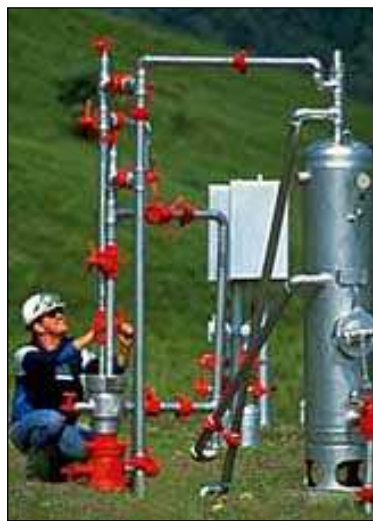
Figure 8 - « Arbre de Noël » connecté à un puits de gaz naturel
