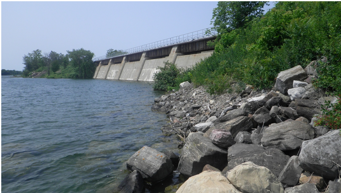
Photo QC-20-1 : Blocs et galets sur la rive sud du remblai aval de la digue (bassin de Saint-Timothée)
